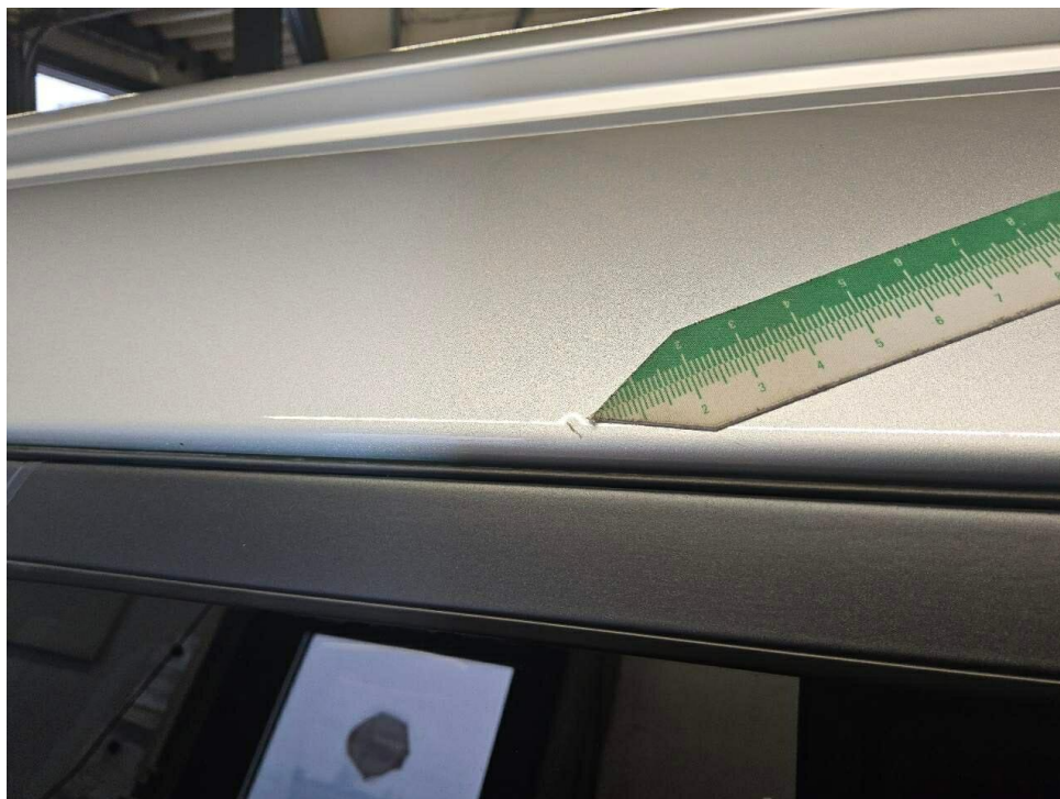
Bild 14 : Dachrahmen rechts, eingedellt, instandsetzen und lackieren mit Lackaufbau
