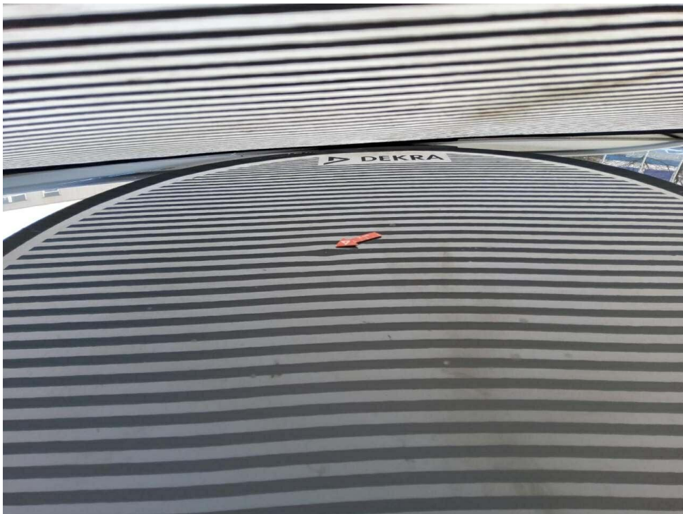
Bild 10 : Dach, mehrfach eingedellt, drücken
