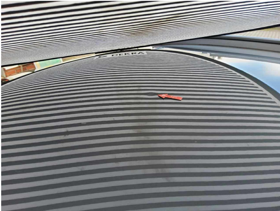
Bild 11 : Dach, mehrfach eingedellt, drücken
