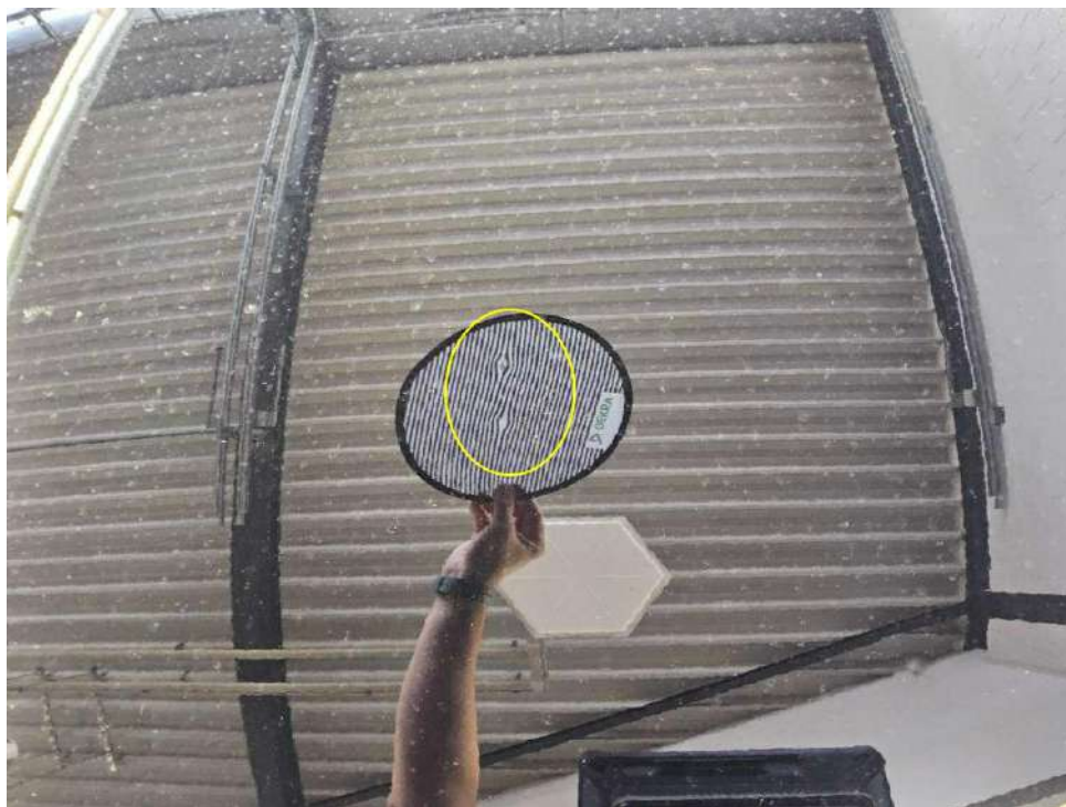
Bild 16 : Dach / Motorhaube Hagelschaden
