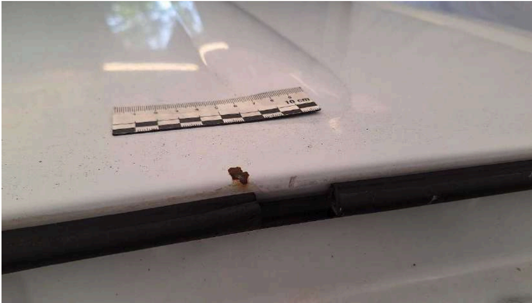
Bild 23 Dach Dachhaut korrodiert
