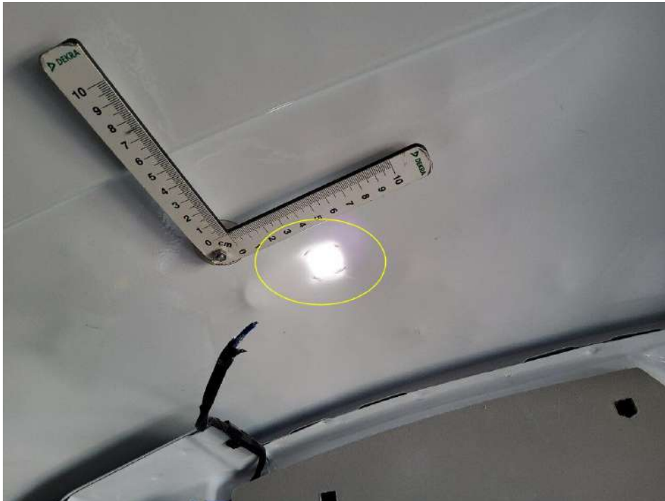
Bild 37 : Öffnung Dachhaut vorn verschlissen
