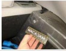
Garnit zone de chargement, Cassé, E - Remplacer
