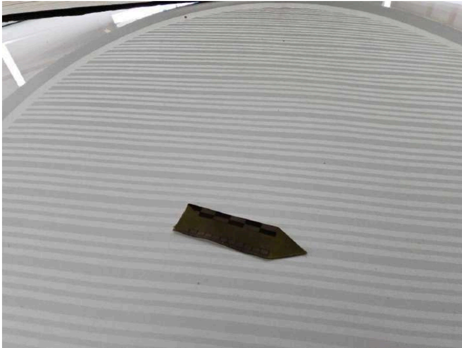
Bild 25 Dach Dachhaut Delle
